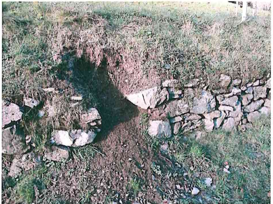
Abbildung 11: Ausgebrochener Teil der Mauer
