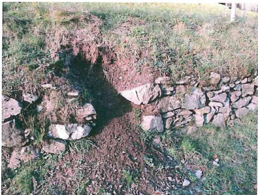
Abbildung 11: Ausgebrochener Teil der Mauer
