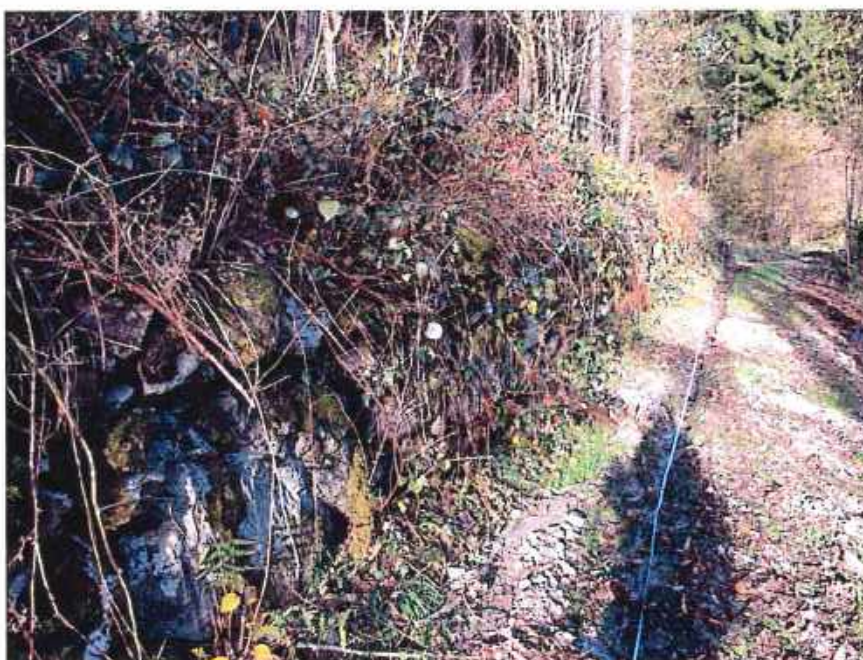
Abbildung 9: Hinterer Teil der Mauer, von oben leicht überwachsen
