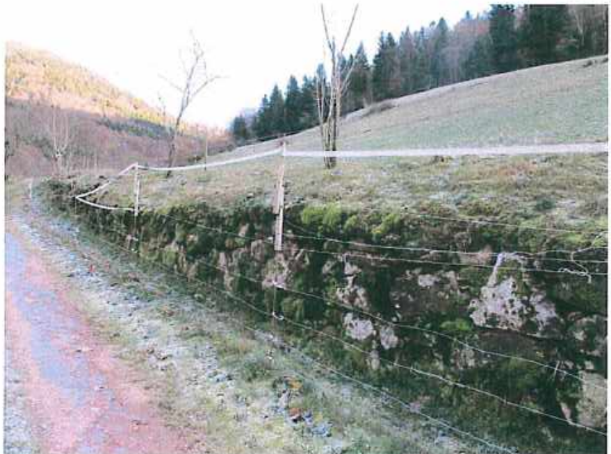
Abbildung 3: Teil der Mauer in rel. gutem Zustand nahe Schuppen
