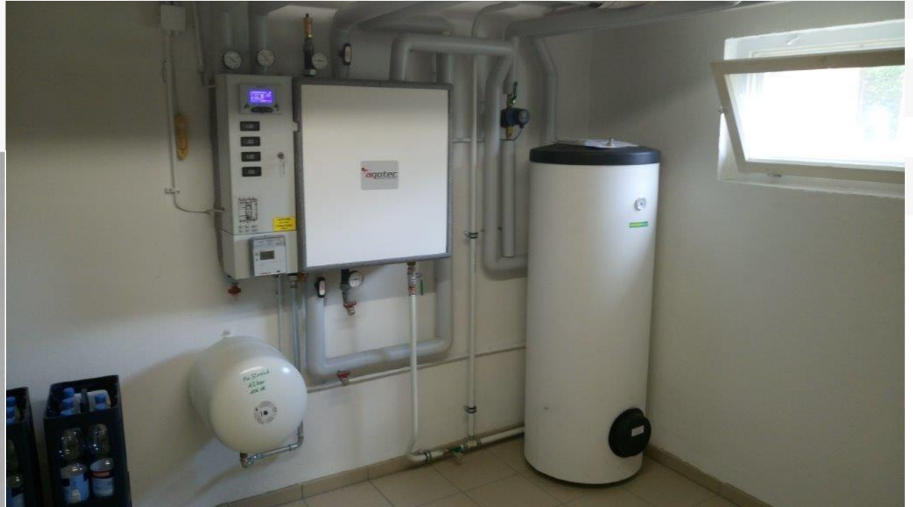
Aufbau Übergabestation mit WW-Boiler
